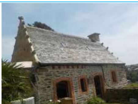
Matériaux : ZPSO-016 Prélèvement : Description : Ardoises naturelles Localisation : Parties extérieures: Toiture oratoire Résultat : Absence d'amiante
