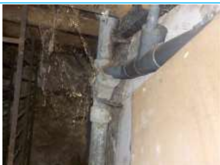
Matériaux : ZPSO-005 Prélèvement : Description : Conduit en fibres-ciment Localisation : Rez de chaussée - Cave Résultat : Présence d'amiante
