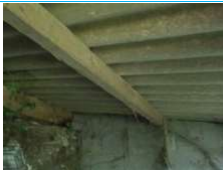
Matériaux : ZPSO-007 Prélèvement : Description : Plaques en fibres-ciment Localisation : Cabanon 1 - Cabanon 1 Résultat : Présence d'amiante
