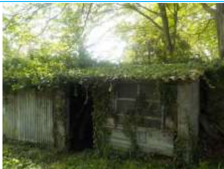
Matériaux : ZPSO-007 Prélèvement : Description : Plaques en fibres-ciment Localisation : Cabanon 1 - Cabanon 1 Résultat : Présence d'amiante
