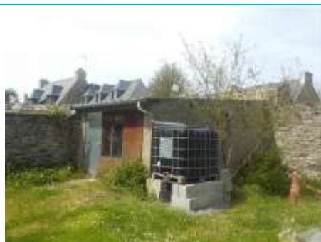
Matériaux : ZPSO-017 Prélèvement : Description : Plaques ondulées bac acier Localisation : Cabanon 2 - Cabanon 2 Résultat : Absence d'amiante
