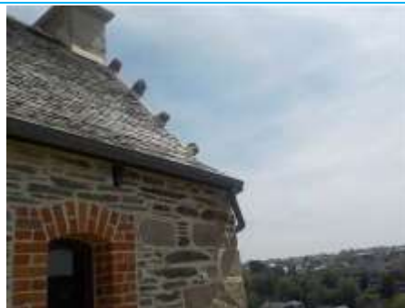
Matériaux : ZPSO-011 Prélèvement : Description : Conduit d'eaux pluviales zinc Localisation : Oratoire Résultat : Absence d'amiante
