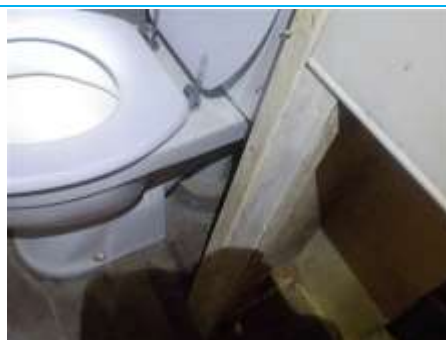
Matériaux : ZPSO-006 Prélèvement : Description : Conduit en fibres-ciment Localisation : Rez de chaussée; 1/2 niveau - Wc Résultat : Présence d'amiante
