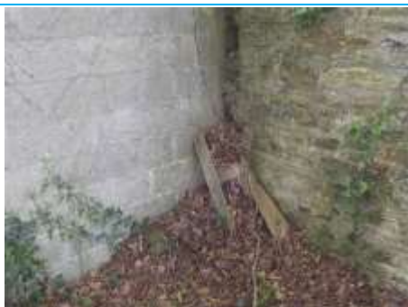
Matériaux : ZPSO-008 Prélèvement : Description : Jardinière fibrociment Localisation : Cabanon 1 - Cabanon 1 Résultat : Présence d'amiante
