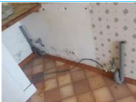
Matériaux : ZPSO-014 Prélèvement : Description : Conduit en pvc Localisation : Rez de chaussée - Cuisine Résultat : Absence d'amiante
